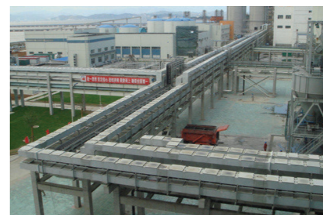
电厂共箱母线应用
