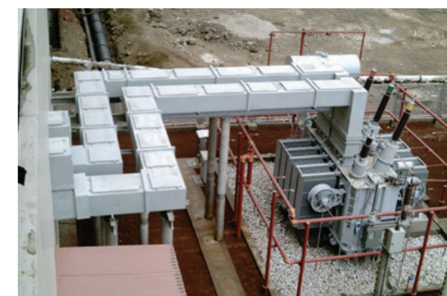
启备变回路共箱母线
